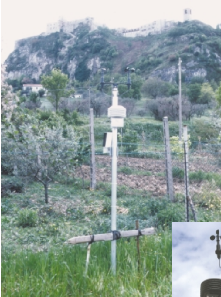
Figura 4. Stazione meteorologica installata nell'oliveto di Villa Verucchio.
